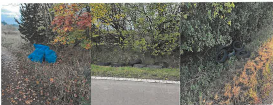
Silniční vpusti – pracovníci pravidelně čistili silniční vpusti a kanálky a odtokové žlaby.
